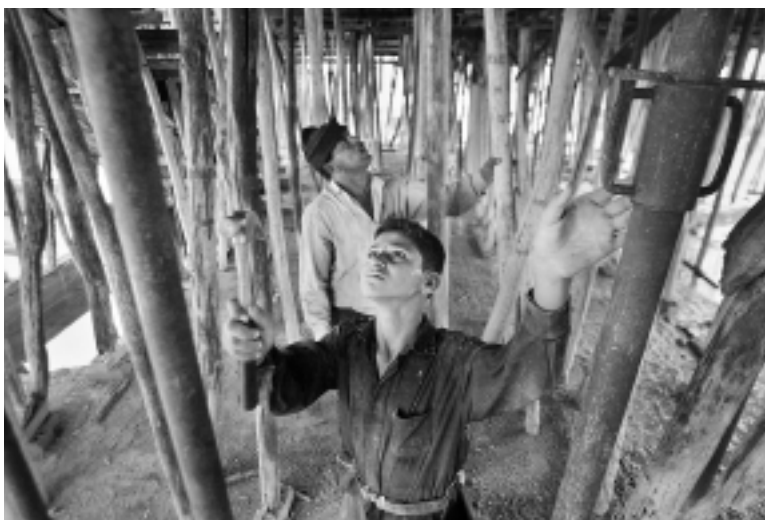
Trabajadores de la construcción en Bagdad. Iraq confía en que la comunidad internacional suministre fondos para reparar su maltrecha infraestructura.
