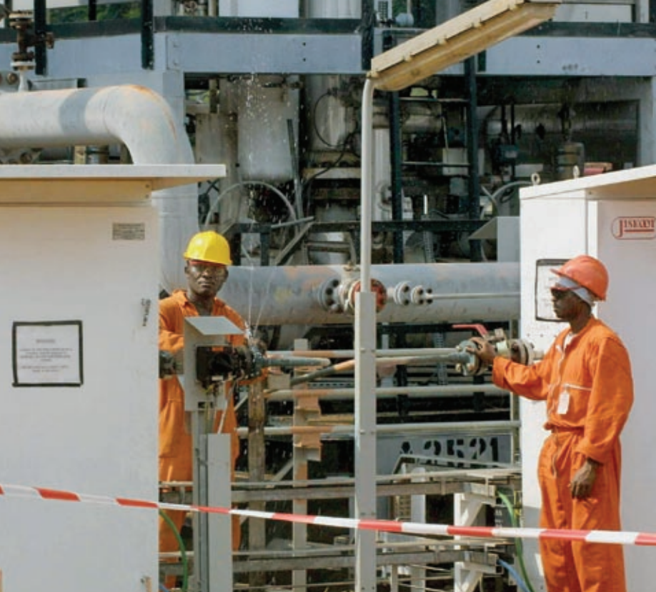
Рабочие на нефтеперерабатывающем заводе в Габоне.
